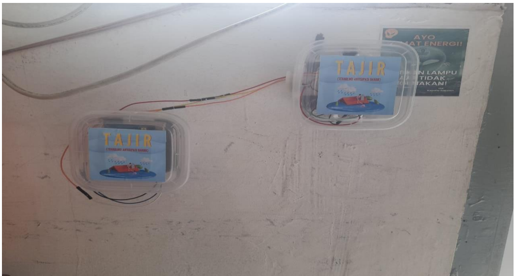
Alat TAJIR yang sudah terpasang di ruang guru
