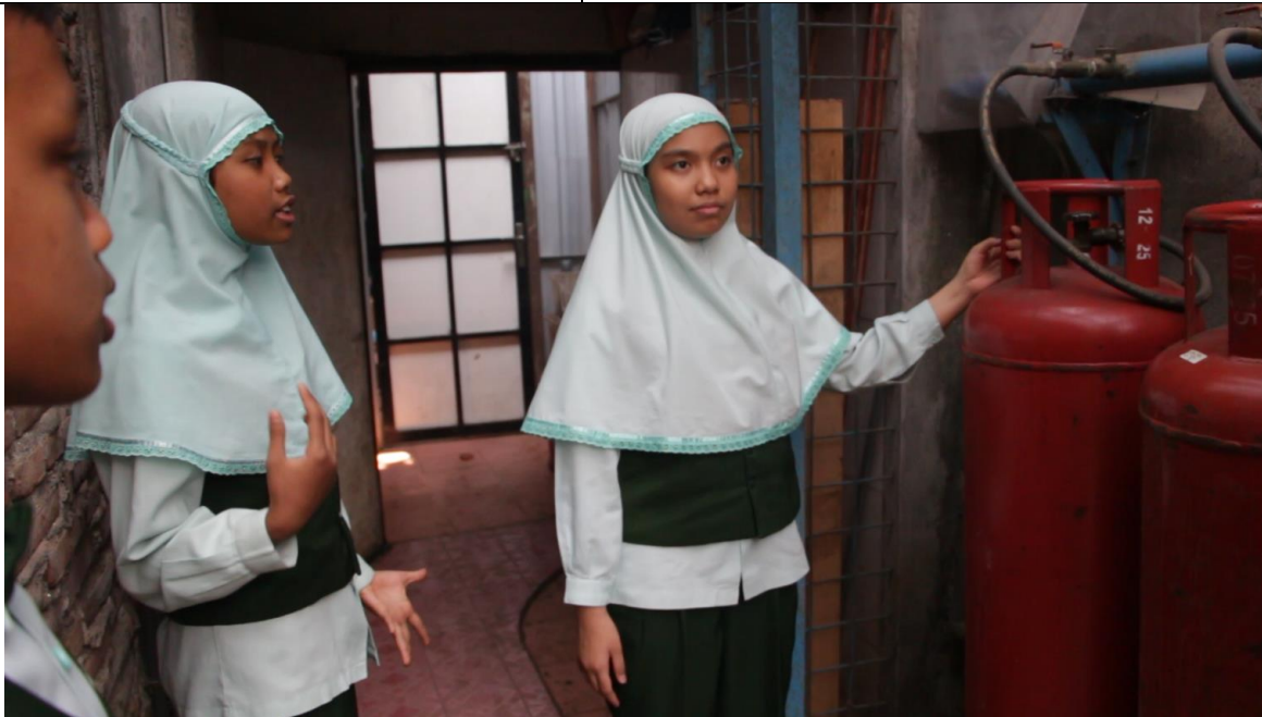
Foto observasi ke dapur Sekolah Unggulan AL-YA'LU bagian instalasi LPG
